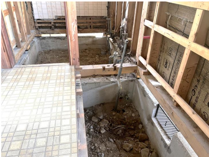
沈下修正状況（内部）
