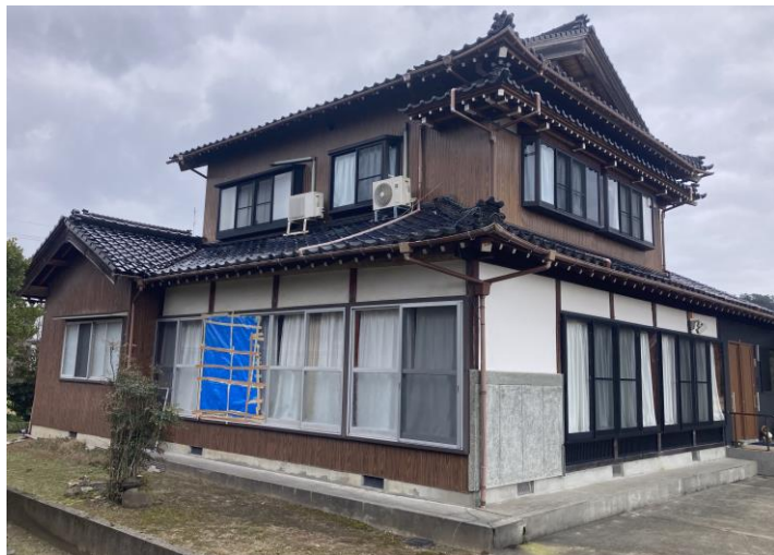
補強前（サッシ破損）
