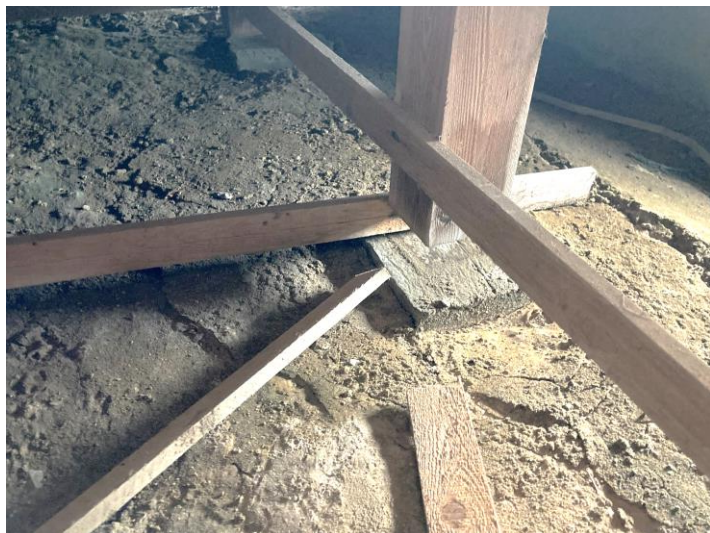
床下 束石部分 沈下
