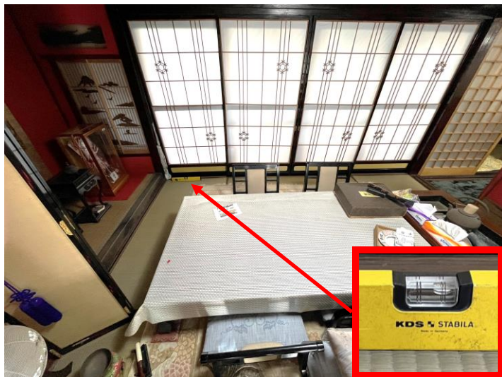
沈下状況（工事前）
