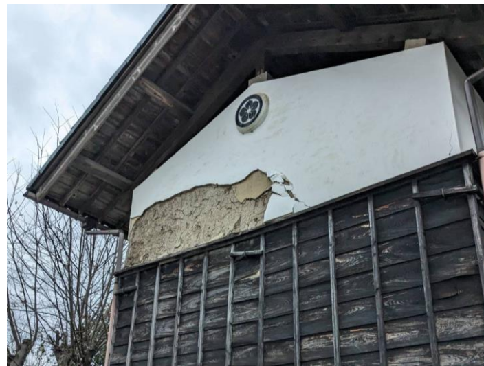
土蔵壁 破損状況
